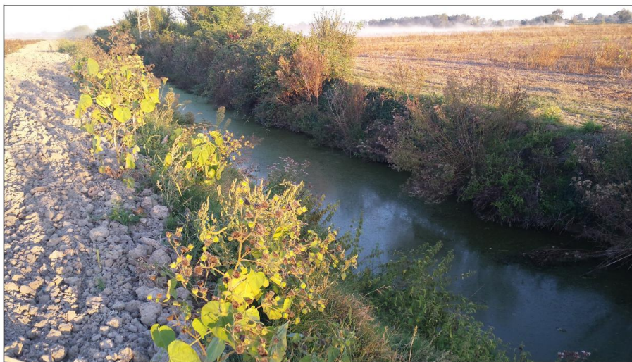
Figura 5 – Vista, verso Est, dell'affossatura minore a valle del depuratore comunale; si nota la presenza del terreno scavato lungo la sponda Nord, a seguito del recente intervento di pulizia dell'alveo (estate 2018)
